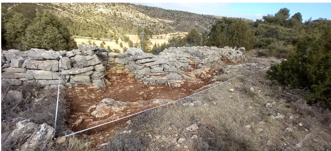
Ilustración 19. Final de la excavación de la UN. EX. 1 de Moracha. (Fotos: SDDS.)
